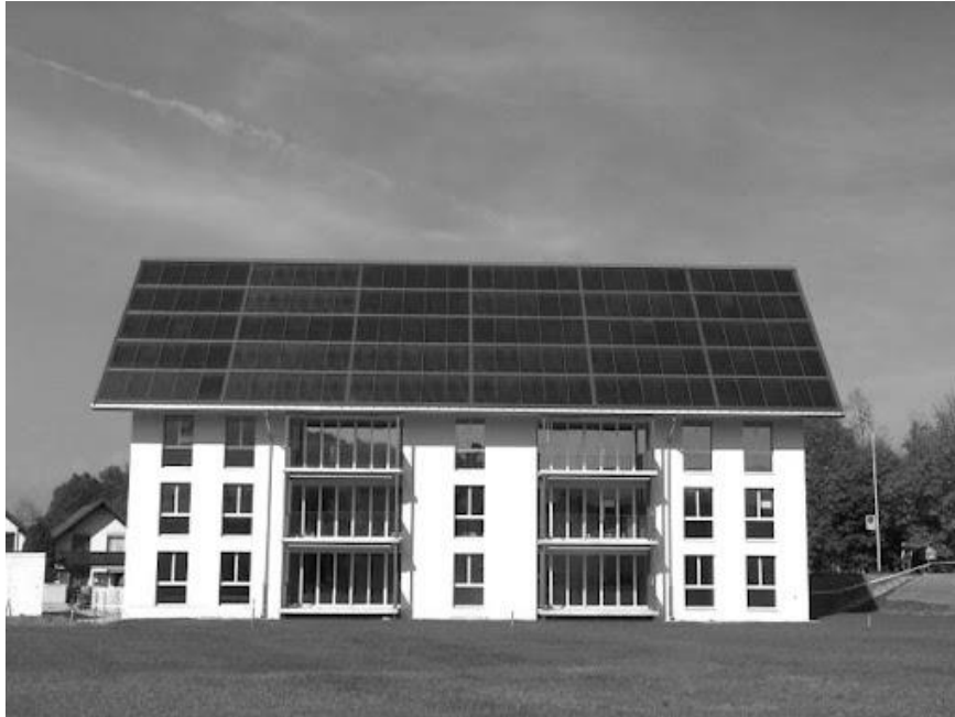
Figura 8. Instalación solar térmica para satisfacer las necesidades de un edificio de departamentos.
