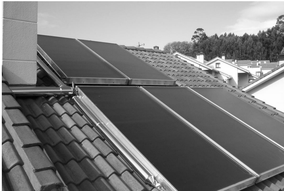
Figura 7. Instalación solar térmica para satisfacer las necesidades de una vivienda unifamiliar.
